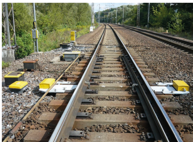
SPA na výhybce
